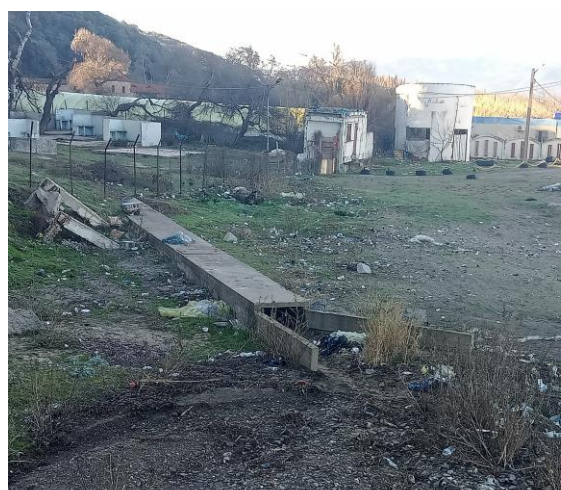
الصورة رقم 56: قناة صرف صحي في شاطئ بني بلعيد الشرقي
